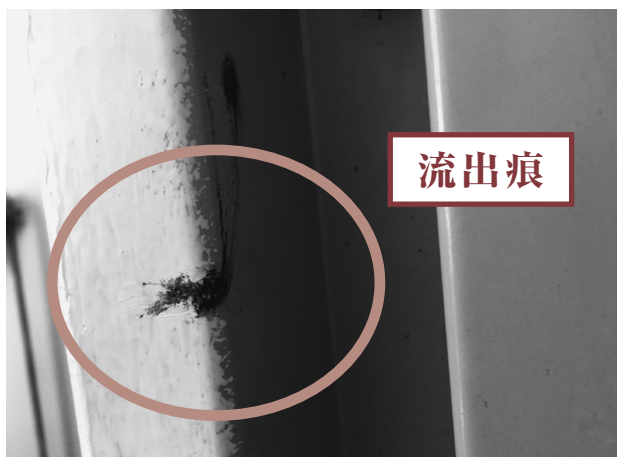
写真3 感電の流出点となったキュービクルフレーム
