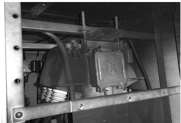
写真1 計器用変成器 焼損状況
