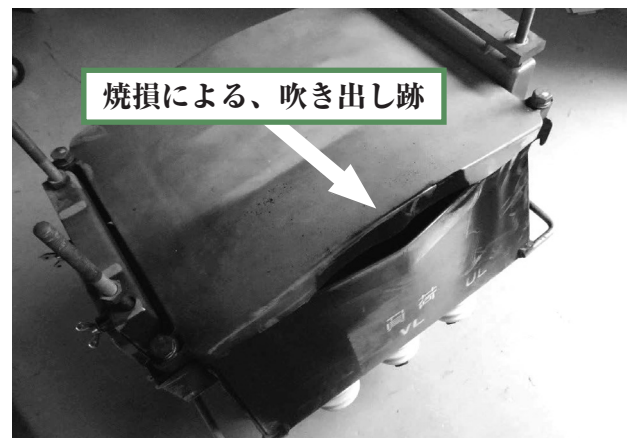
写真2 計器用変成器 焼損状況
