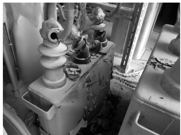
写真1 焼損した高圧コンデンサ付近の様子
