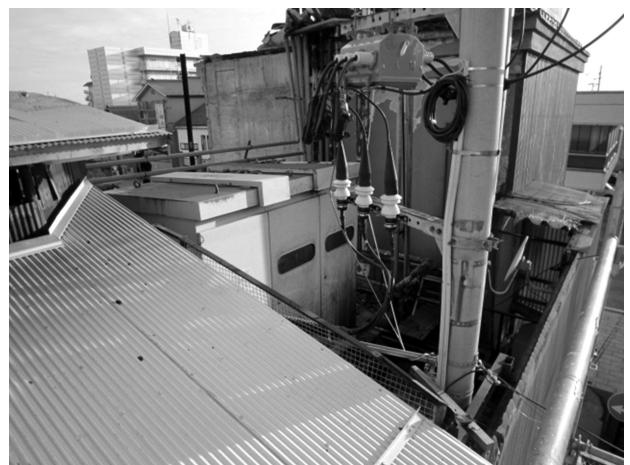
写真3 屋上キュービクルと構内第一柱
