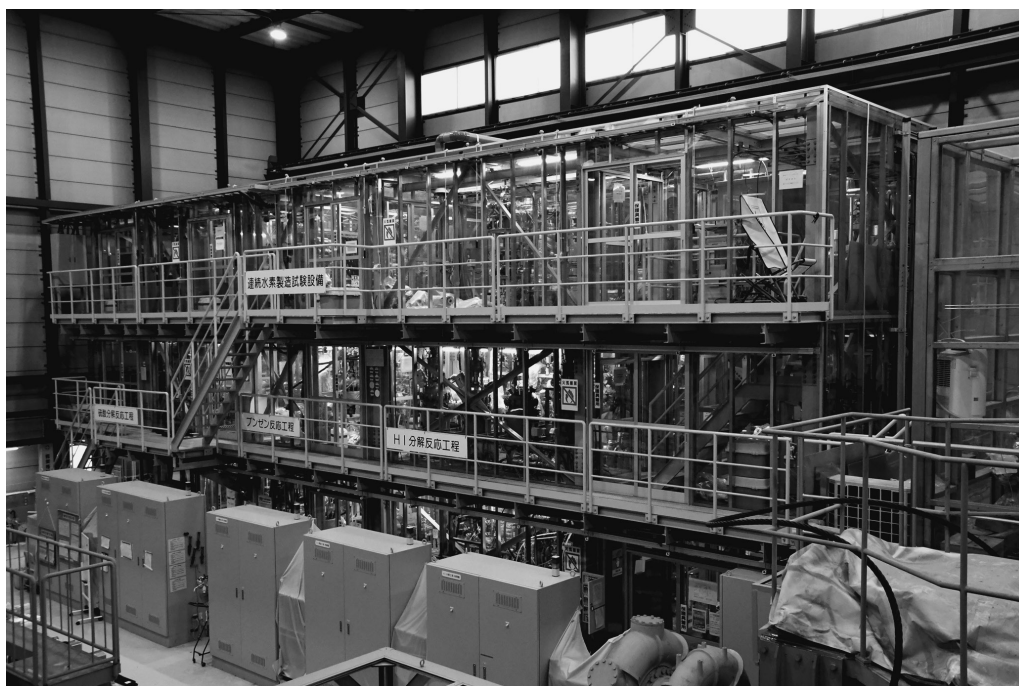
大洗研究所に設置されている「ISプロセス連続水素製造試験装置」
