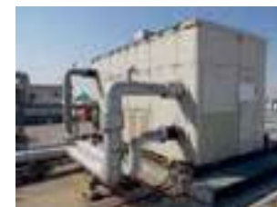
ガス焚冷温水発生機
