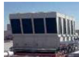
空冷ヒートポンプチャラー
