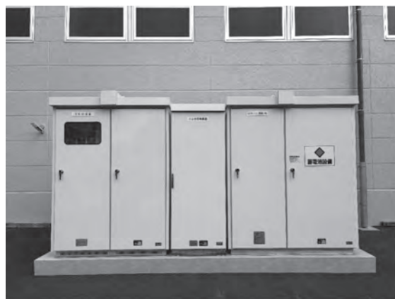
図1：(株)ダイヘンのリチウムイオン蓄電池設備
